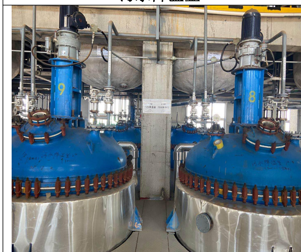
污水降温釜装置
