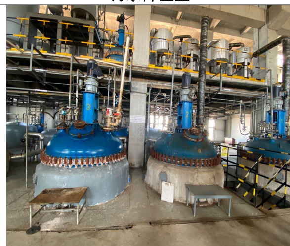
污水降温釜装置
