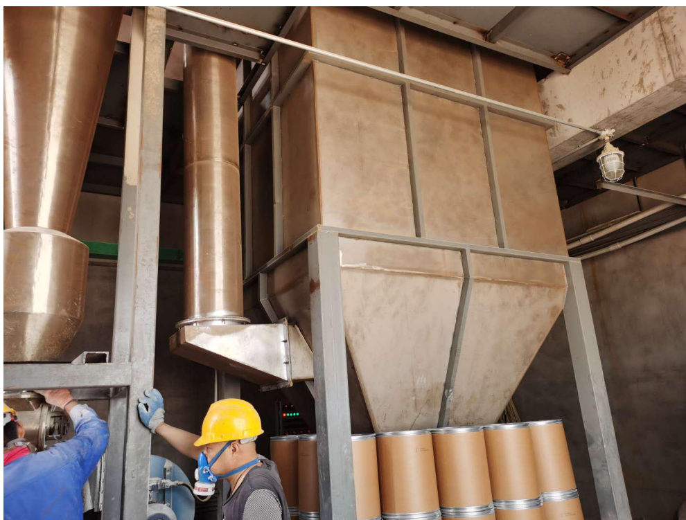
图 4-11 车间布袋除尘器
