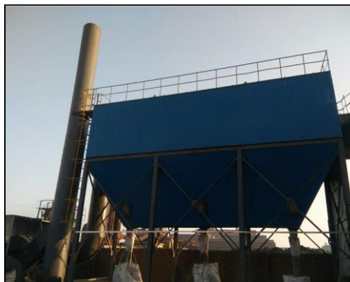
电弧炉除尘器
