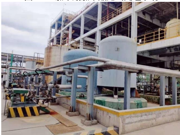
图 4-4 氯甲酸氯甲酯尾气处理储罐区
