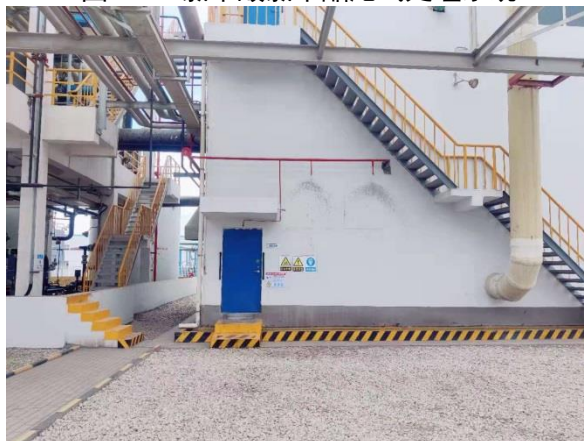
图 4-5 液氯库房喷淋装置（红色管道）
