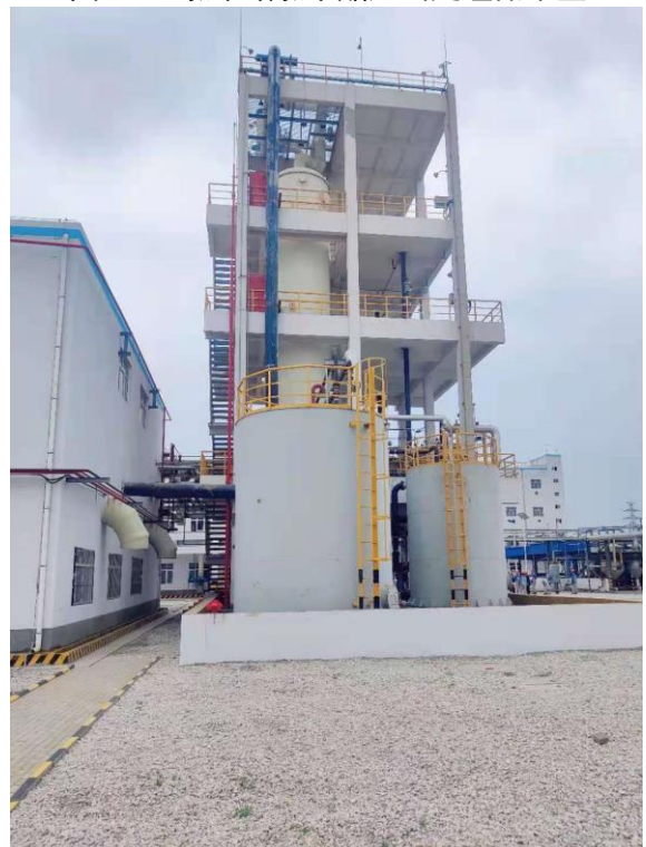
图 4-6 液氯库房尾气处理系统及罐区
