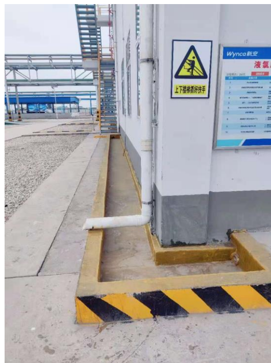
图 4-11 生产车间导流槽
